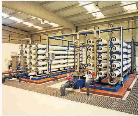
ETAP. Estación de Tratamiento de Agua Potable de Facsa en la provincia.
