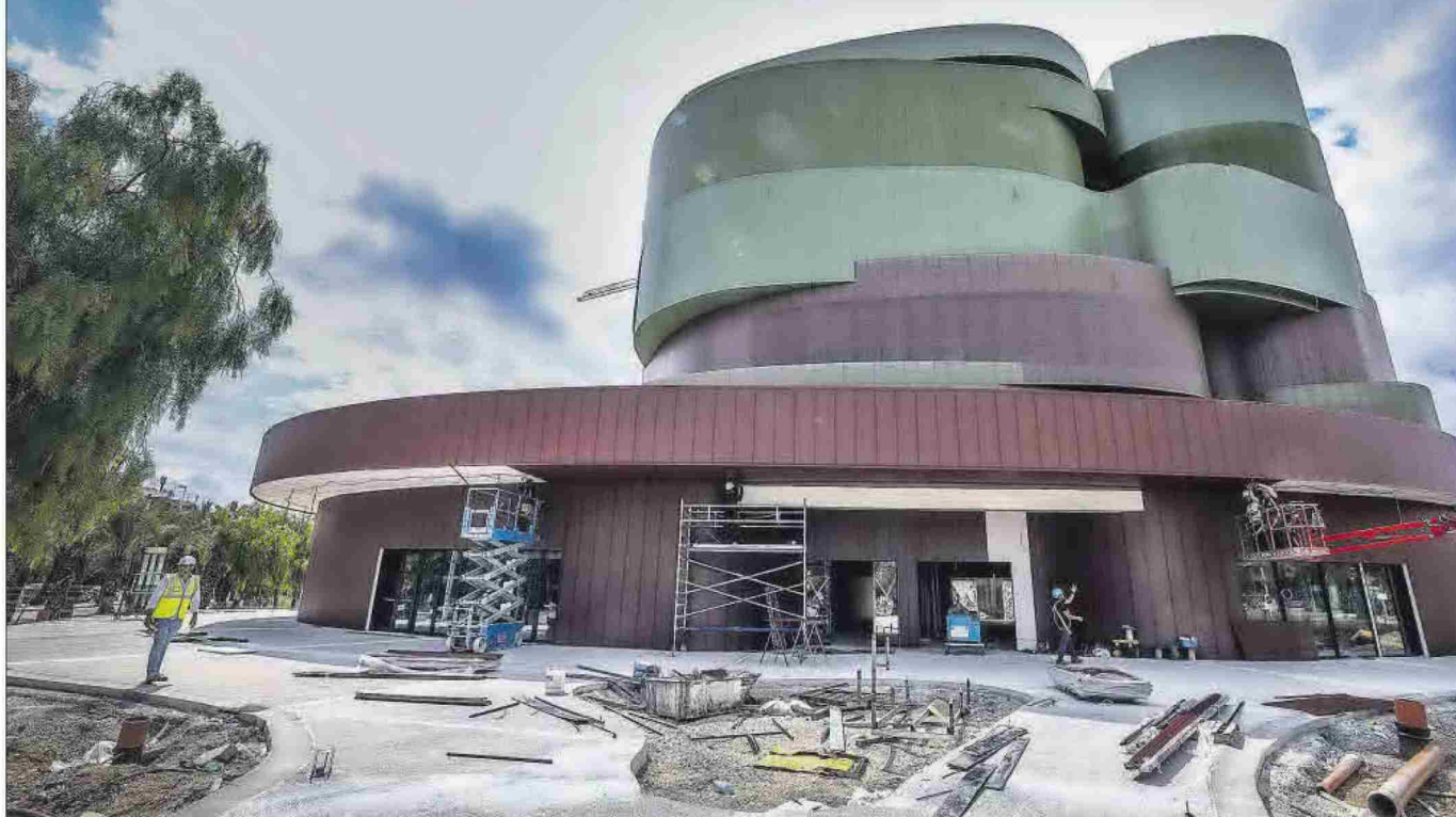
Una imagen que muestra la espectacularidad del edificio, con sus colores verde y marrón simulando la copa de las palmeras, y lo avanzados que están los trabajos.
