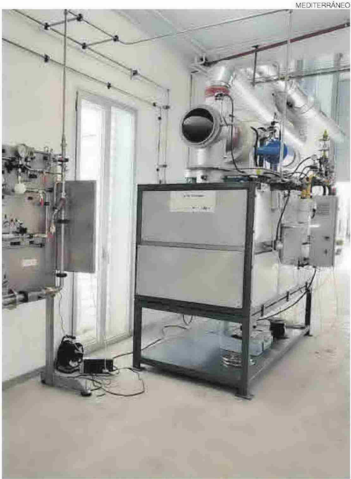
El instituto tecnológico experimenta en sus instalaciones con hidrógeno.
