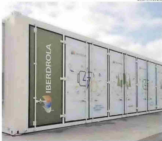
Una bateria fotovoltaica d'energia renovable d'Iberdrola en Arañuelo.
