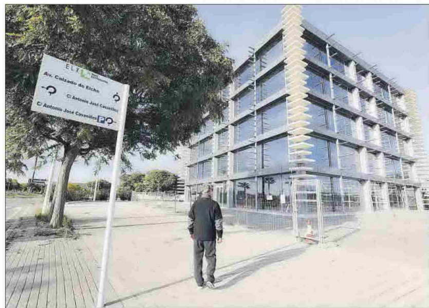
El segundo inmueble del proyecto tiene por acabar la fachada, que irá con unas lamas.
