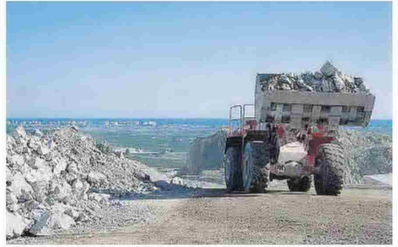
Residuos de construcción.
