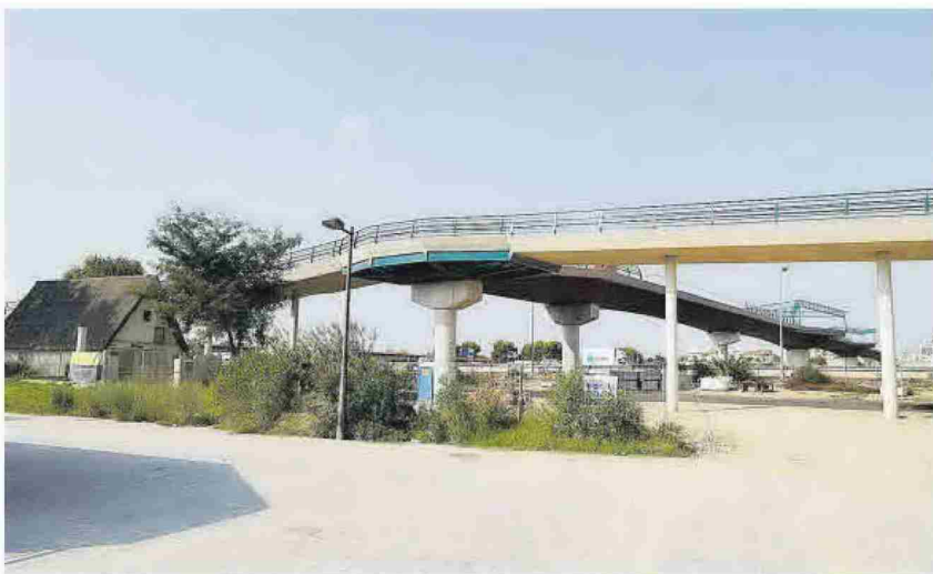
La plataforma ciclopeatonal de La Torre, aún en obras, unirá la pedanía con València.
