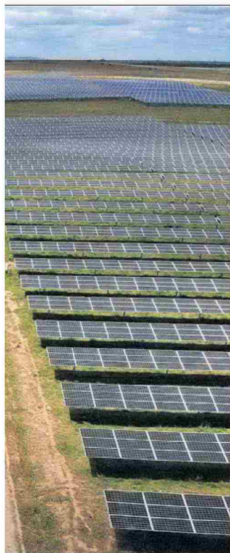
Planta fotovoltaica en Trujillo (Cáceres), el pasado 13 de mayo. / PAO PUNTES
