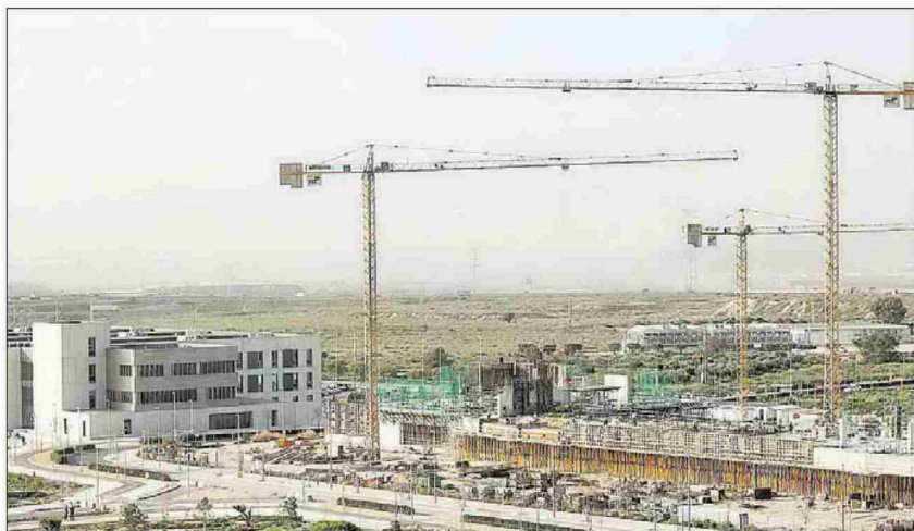
Vista de parte del Parque Científico de la Universidad de Alicante, donde se instalará Ellis. ALEX DOMÍNGUEZ
