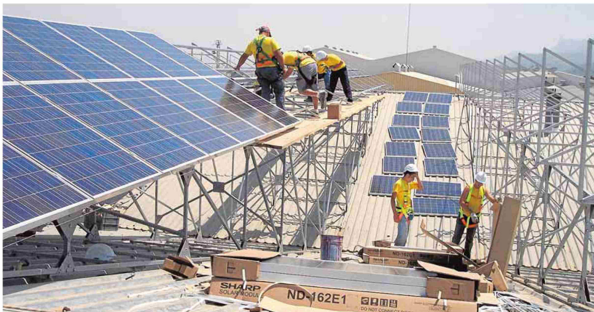
Colocación de paneles fotovoltaicos, para producir electricidad directamente del sol, sobre el techo de un inmueble en Castellón. ▄▄ LP
