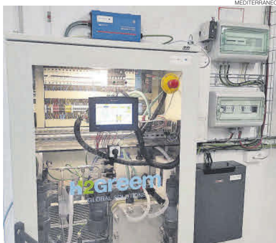
Imagen del demostrador de producción y almacenaje de hidrógeno verde.
