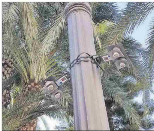
Uno de los medidores instalado en una farola.
